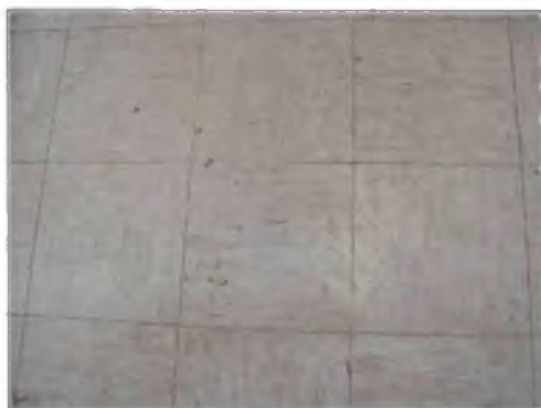
Rys. 8 Płyta podłogowa azbestowa
