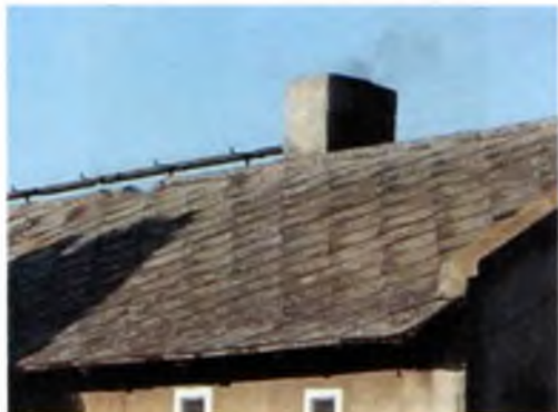
Rys. 4 Płyta azbestowo-cementowa karo
